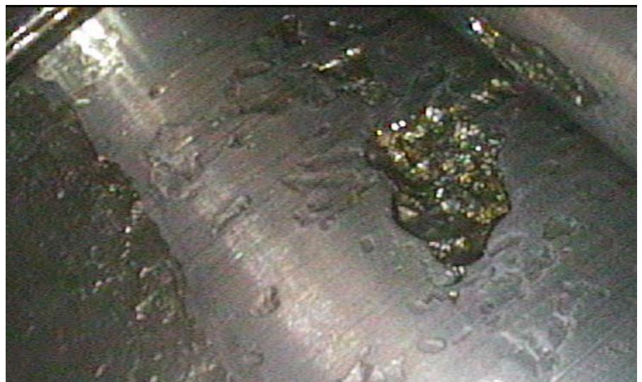
Er skaden pludseligt opstået eller på grund af slid? Det er afgørende for, om forsikringen dækker skaden. Skaden på dette planetleje blev heldigvis fundet med endoskop inden udløb af garantiperiode.
